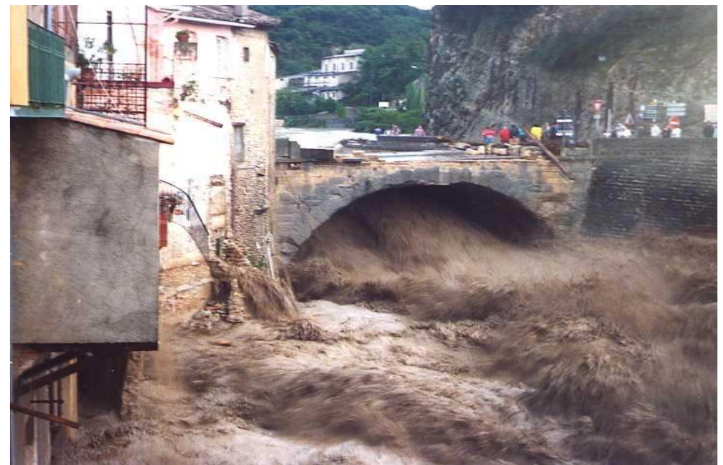
Crue du 22 septembre 1992
